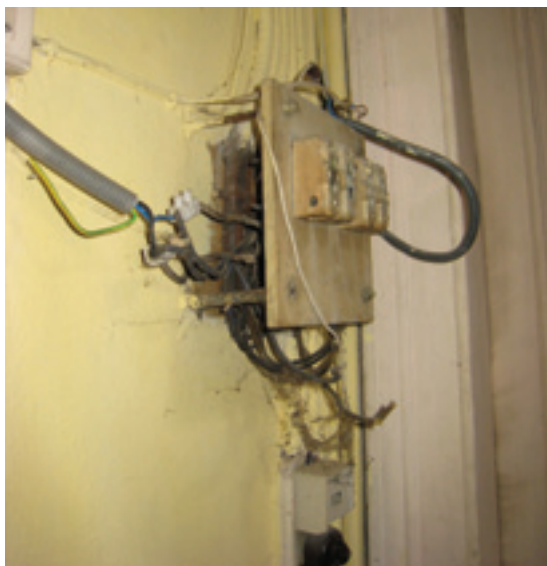
Danger mortel d'électrocution.
