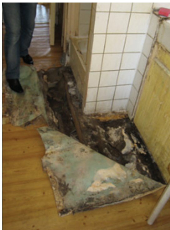
Effondrement du sol suite à une infiltration.
