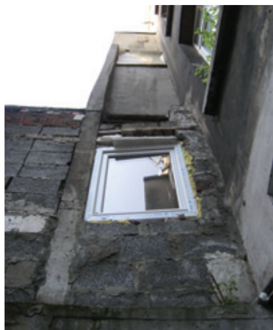
Stabilité très précaire de cette annexe.
