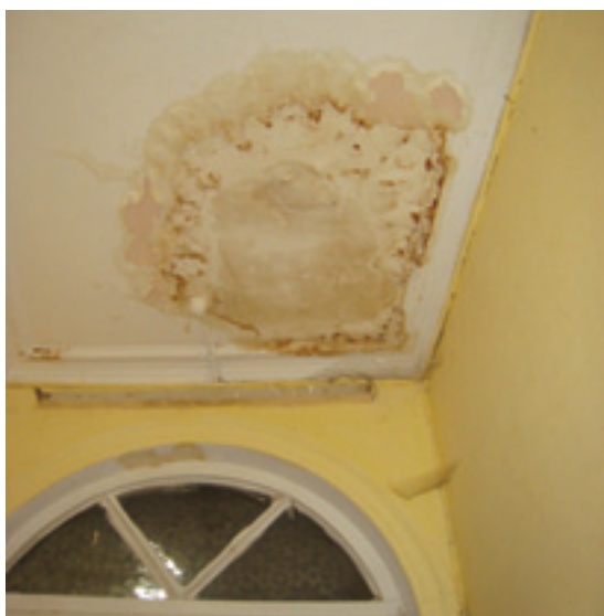
Le résultat d'une infiltration d'eau dans le plafond d'un hall d'entrée.
