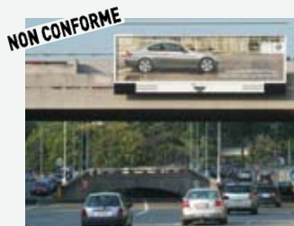
Dispositif de publicité non conforme car la publicité est interdite sur les ouvrages d'art.
