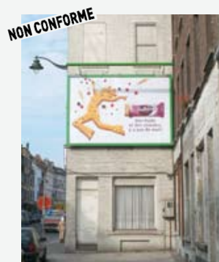
Dispositif de publicité sur pignon non conforme situé à moins de 0,50 m des limites du pignon, nuisant à l'habitabilité en masquant les baies.
