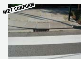
Niet-conforme plaatsing van de rioolkolk daar geplaatst ter hoogte van het zebrapad.
