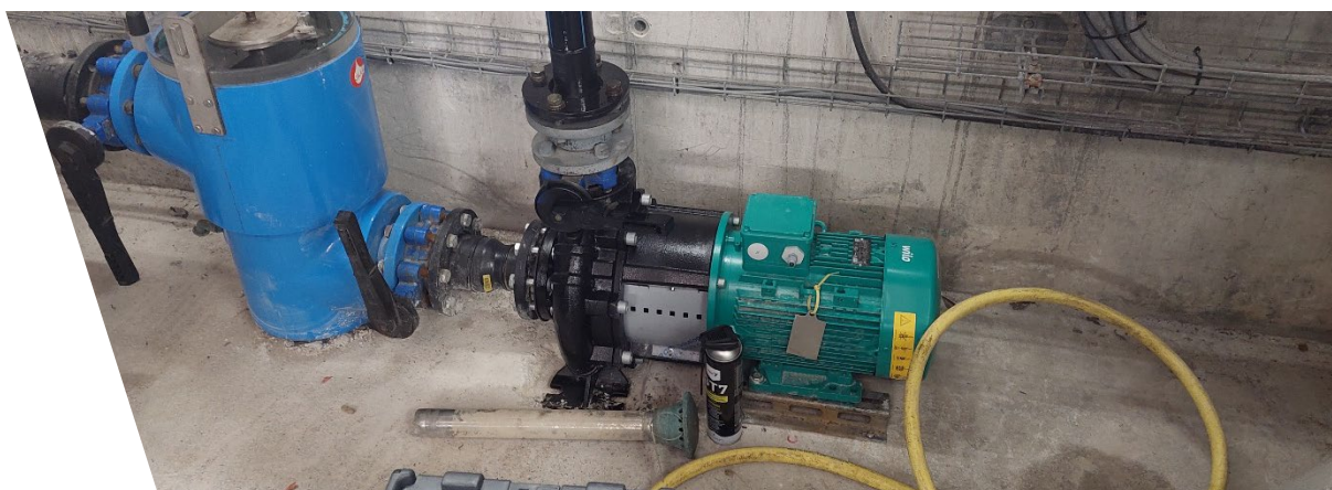
Figure 1 : exemple de pompe à sec installée dans un local technique
