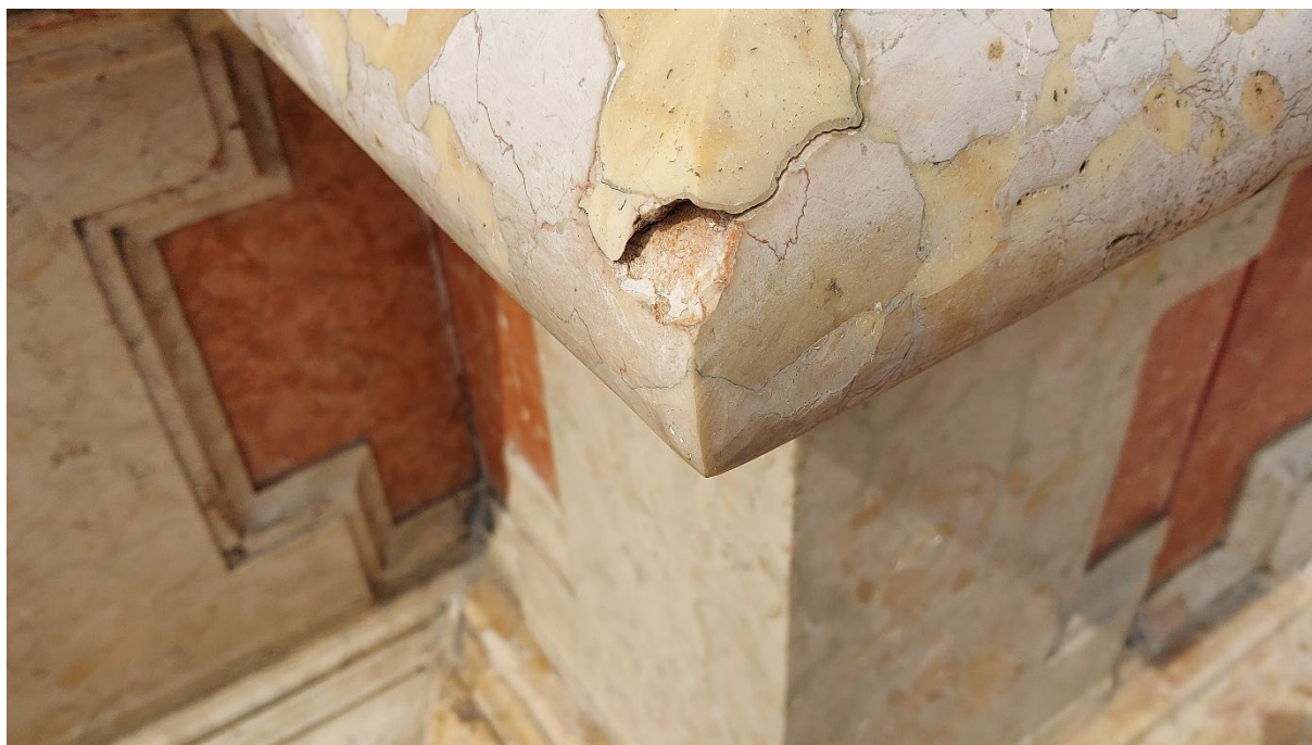
Figure 1: fontaine Neptune, architecte Elie Lainé. Avenue Van Praet, 1020 Laeken. Exemple de détérioration d'une réparation époxy.
