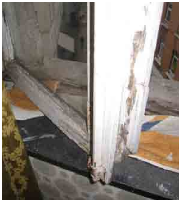
Raamwerk in zeer slechte staat. Laat regen en wind door.
