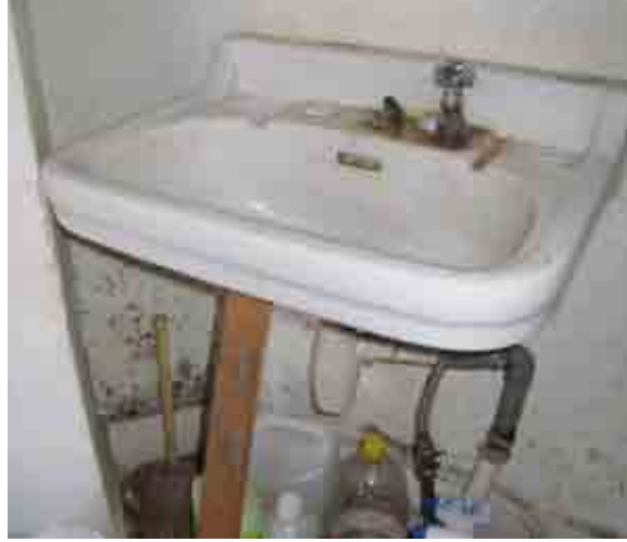
Wasbak zonder warm water, op zijn plaats gehouden door middel van een houten plank. Vochtige muren
