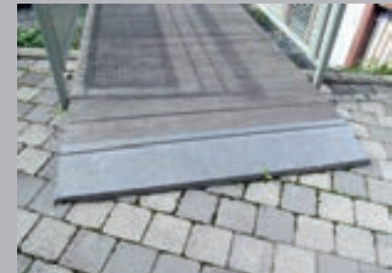
✗ Drempel aan het begin van de toegangsweg
