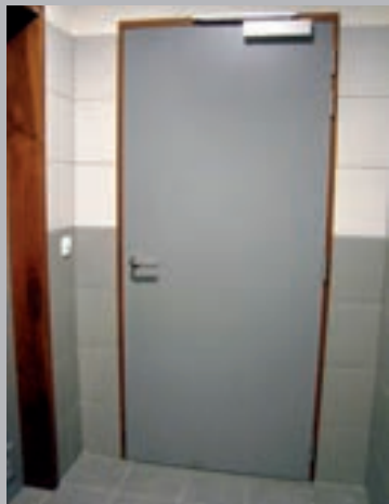
✘ Onvoldoende zijdelingse opstelruimte aan de kant van de deurklink
