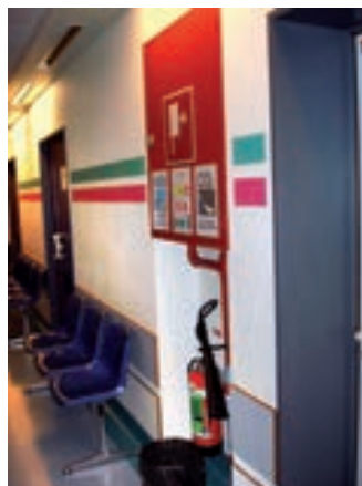
✓ Brandblusapparaat aangebracht in een nis
